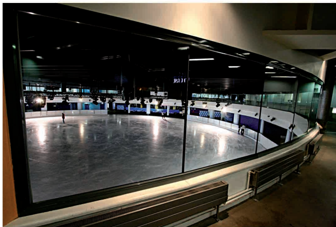
Vitrage périphérique - Chassis acier coupe-feu avec vitrage coupe-feu
